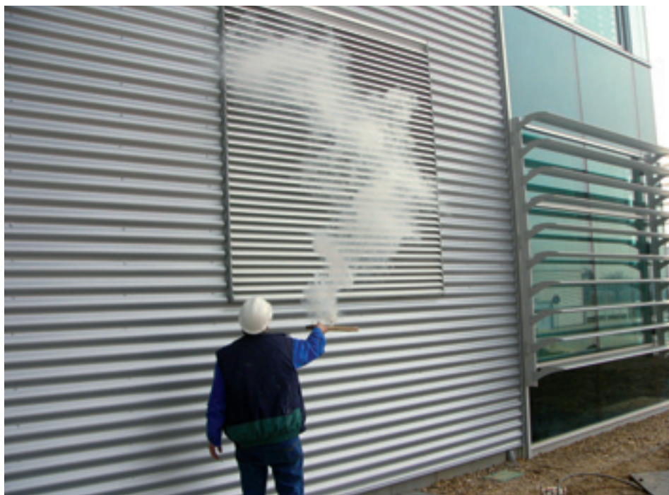
← Zkouška reakce systému na přítomnost kouře v potrubí
