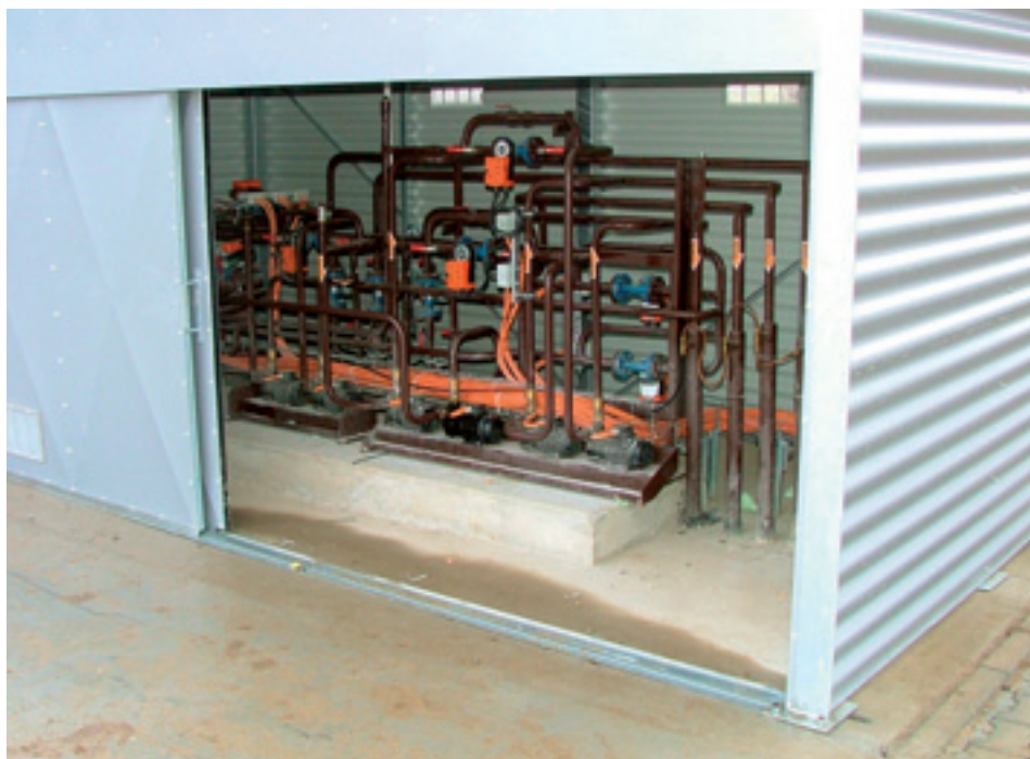
← Strojovna naftového hospodářství
