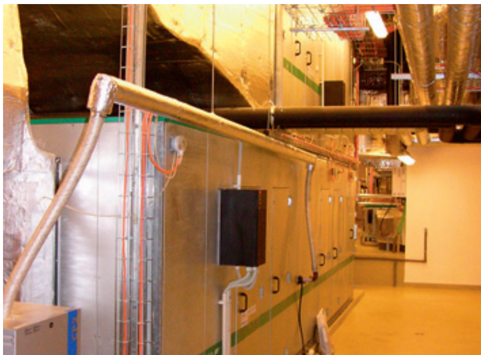
← Vzduchotechnická jednotka pro sál ATS
