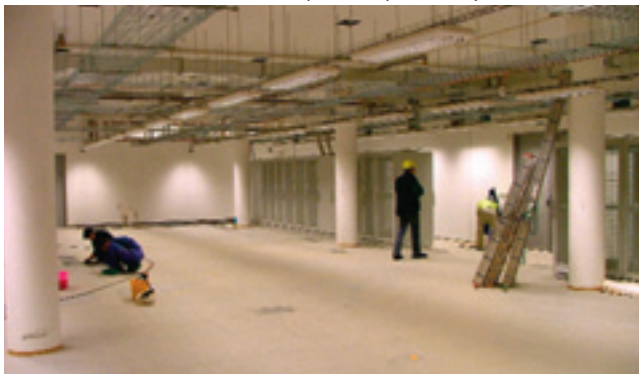
Elektronické srdce IATCC – centrální sál technologií (CST) je v podstatě dokončeno a začínají se instalovat první stojany. Podlaha sálu má již finální podobu, a tak vstup sem je podmíněn návleky přes boty
