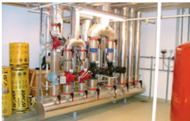
A tahle krása se nazývá „rozdělovač“. Je trošku větší než ten v autě, má ale podobnou úlohu. Je umístěn v kotelně, a tady v IATCC bude mít na starosti rozvod topné vody
