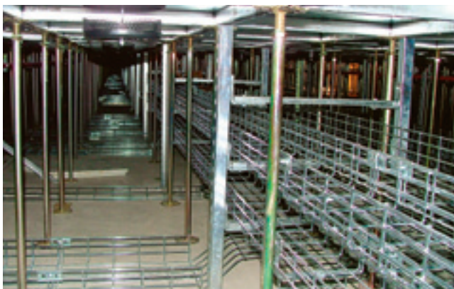
Tento pohled se naskytne každému, kdo se podívá pod již dokončenou podlahu provozního sálu ATS. Výška podlahy jeden metr, rozteč podpěr 60 cm a množství kabelových žlabů vytvářejí z tohoto prostoru o výměře více než 900m 2 docela slušné bludiště
